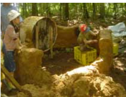
積み上げた壁が崩壊！水分が多かった・・・
