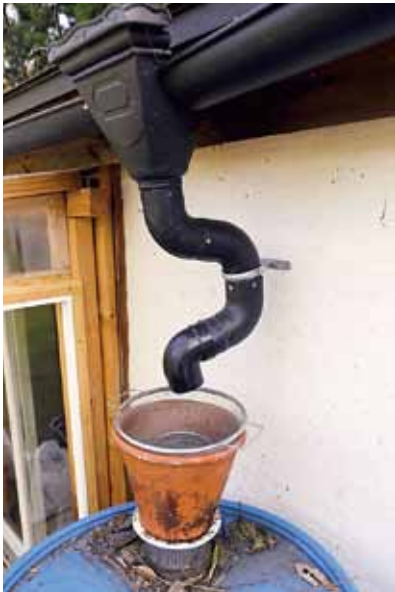
屋根に降った雨水は雨どいを通り、雨水タンクへ。砂と砂利と炭のバイオフィルターでこれが浄化される。
