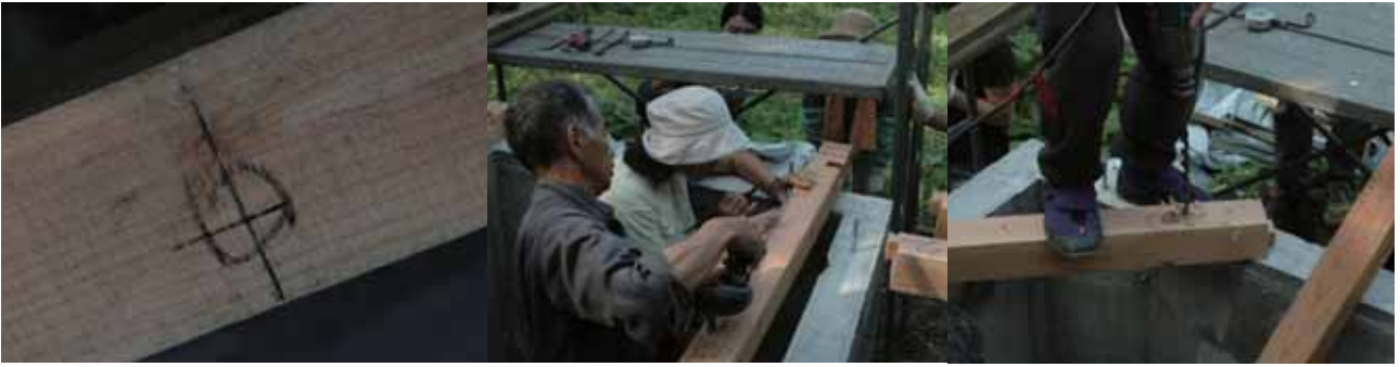
土台を墨に沿って置きアンカーボルトに両端に墨を打ち中心線を求めます。そして端から何寸あるかをはかり土台に墨を打ちます。墨刺してバテン、そしてをつけておきます。×部分を、ドリルで穴を開けます。
